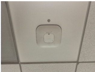
LAN & VoIP Syste67080
